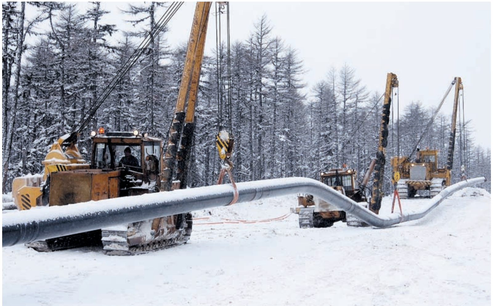
Томское ЛПУ МГ ежегодно проводит капитальный ремонт и обновляет десятки километров газовой магистрали
