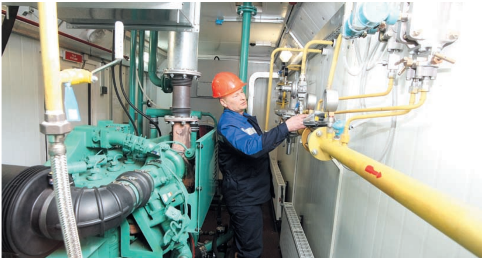
В экономии нужен комплексный подход. Поэтому модернизация касается и установки современных электродвигателей на вспомогательных объектах станций, и замены устаревших лам освещения, и регулирования работы газовых котельных
